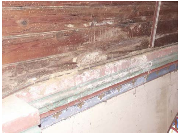
39 - Moisissures sur la corniche et les bois de la carène en deuxième travée au Nord de la nef
