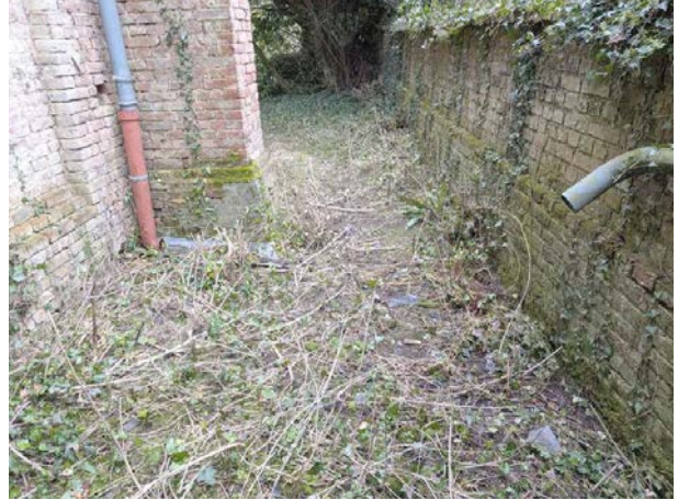
30 - Dauphin en fonte et "caniveau" en plomb rejetant les eaux de pluie en pied du contrefort ; à droite gouttière rejetant les eaux de pluies de la couverture de la sacristie
