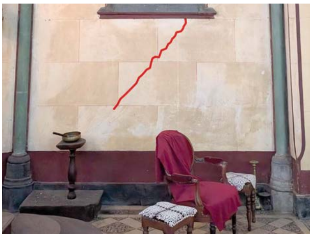
17 - Fine fissure sous la baie de l'élévation Sud du choeur
