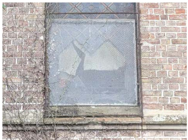
43 - Verrière du pan axial du chevet, très lacunaire, à restaurer ; deux protections différentes sont visibles, en mauvais état
