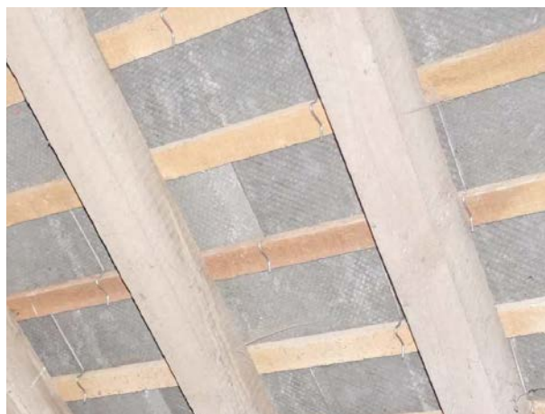
22 - Sous-face des ardoises de la nef : la maille de fibre est caractéristique des ardoises synthétiques
