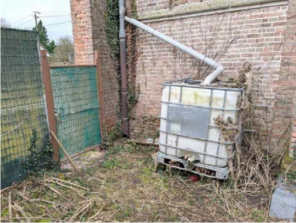
29 - Vue d'ensemble de la gestion terminale des EP en première travée de la nef au Sud : dauphin rejetant les eaux de pluie en pied d'élévation et cuve inopérante
