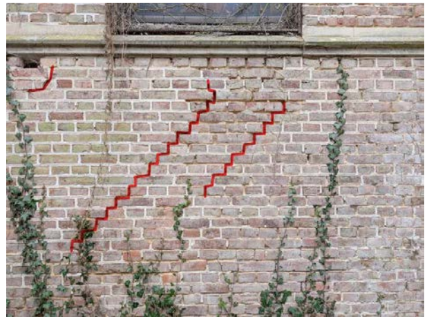
15 - Fissures en escalier, en dernière travée de l'élévation Sud de la nef
