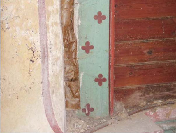
11 - Vue en contre-plongée du décalage entre la carène de la nef et la tribune, comblé par de l'isolation
