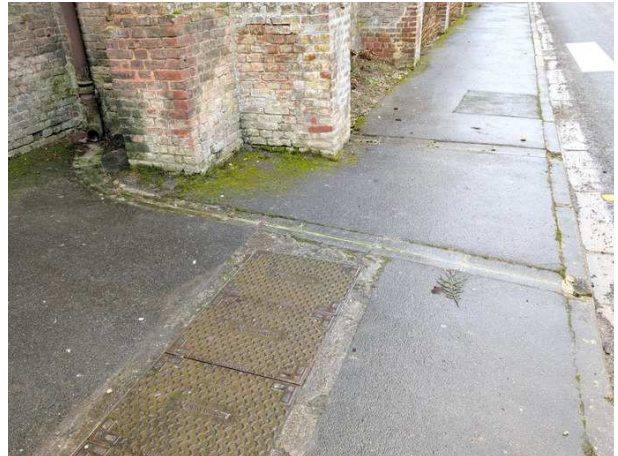
32 - Dauphin et caniveau à ciel ouvert dont les joints sont lacunaires ; la pente du trottoir en asphalte devra être reprise, car elle n'éloigne pas les eaux de pluies des pieds d'élévations, ce qui favorise la colonisation végétale par les algues et les mousses
