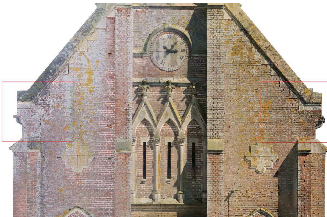
2 - Localisation des maçonneries fissurées au-dessus des contreforts de la façade occidentale Extrait de l'orthophototype numérique de Drones BTP
