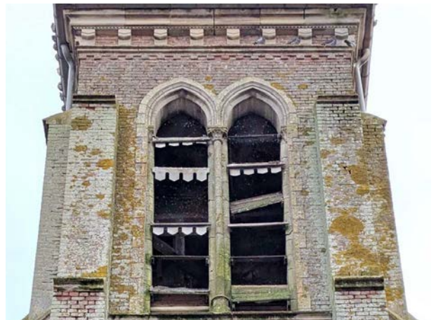
6 - Lacunes de joints généralisées en partie haute du clocher - les abats-sons sont également en état de ruine
