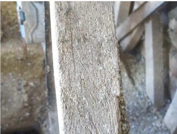
38 - Trous d'envols d'insectes xylophages sur les charpentes du beffroi des cloches
