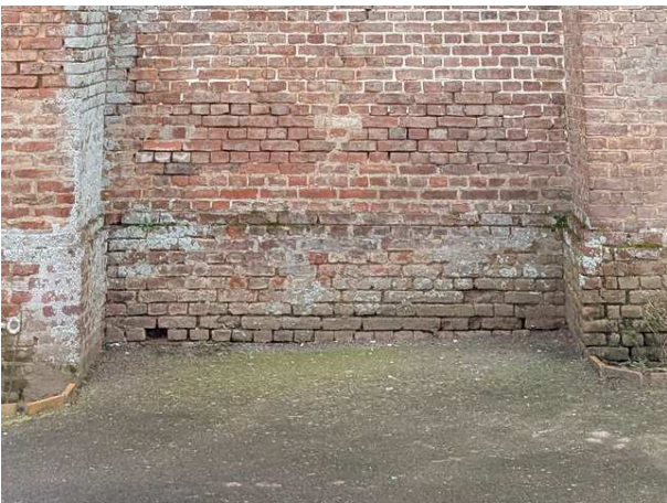
5 - Vidage généralisé des joints de parement et lacunes de briques en soubassement de la façade occidentale
