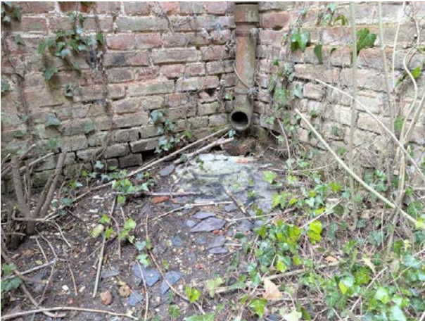
31 - Dauphin en fonte à l'angle du choeur et de la nef, au Sud de l'église : les EP sont rejetées en pied d'édifice
