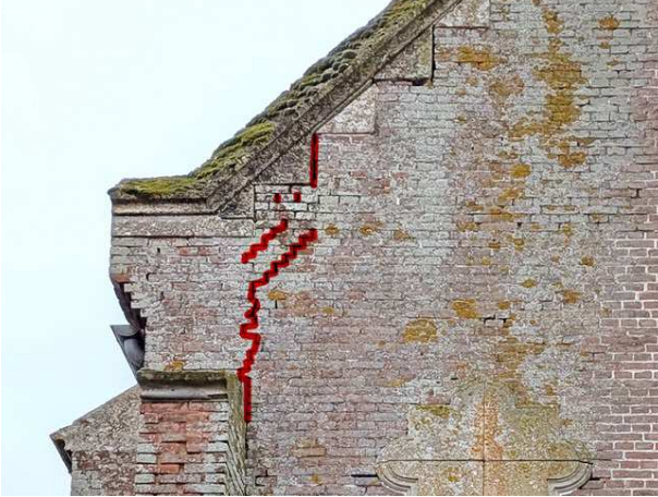
3 - Successions de joint vidés à l'angle Nord-Ouest de la façade, avec quelques briques fracturées
