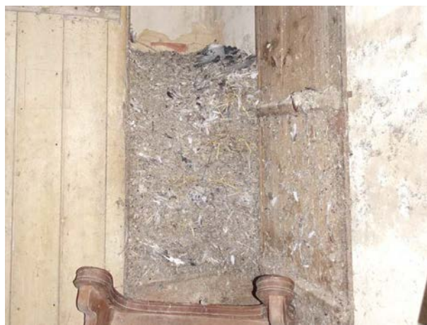
35 - Accumulation d'un mètre de fientes, plumes et cadavres de pigeons dans l'escalier menant au clocher ! Un nettoyage a depuis été effectué, mais il sera à reproduire régulièrement, tant que les pigeons pourront pénétrer le clocher.
