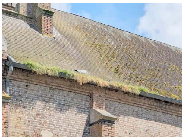
28 - Herbacés dans l'égout aérien du versant Sud de la couverture de la nef - à curer
