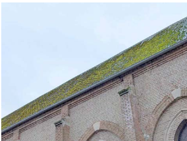
21 - Colonisation du versant Nord du comble de la nef par les mousses
