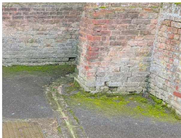
18 - Affaiblissement des maçonneries en pied du choeur
