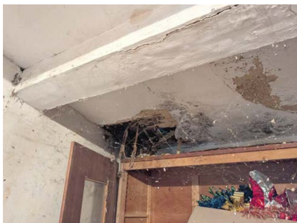
27 - Sous-face de la sacristie : le plafond est ruiné ; la charpente est probablement pourrie
